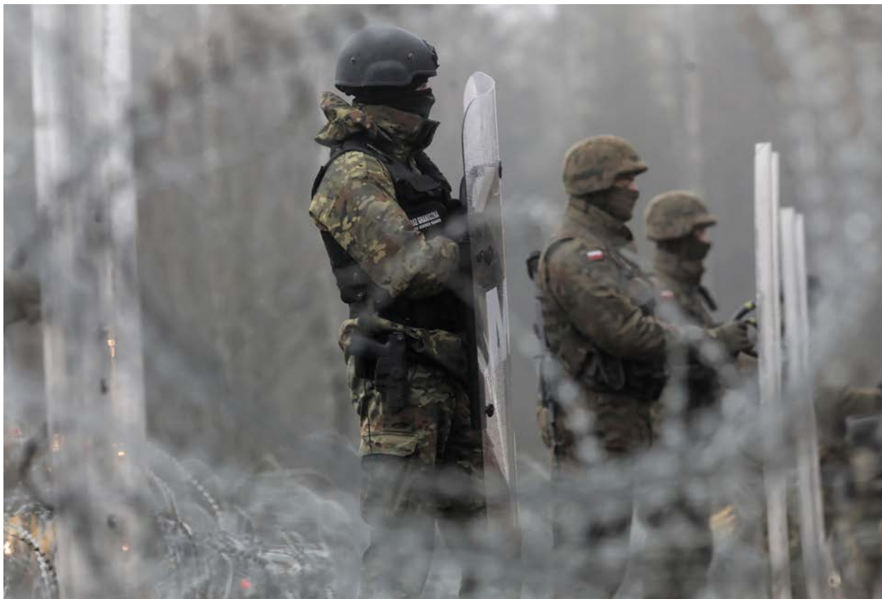
Styczeń 2022 r., okolice wsi Tołcze w gminie Kuźnica. Budowa zapor na granicy z Białorusią. Fot. PAP/Artur Reszko
